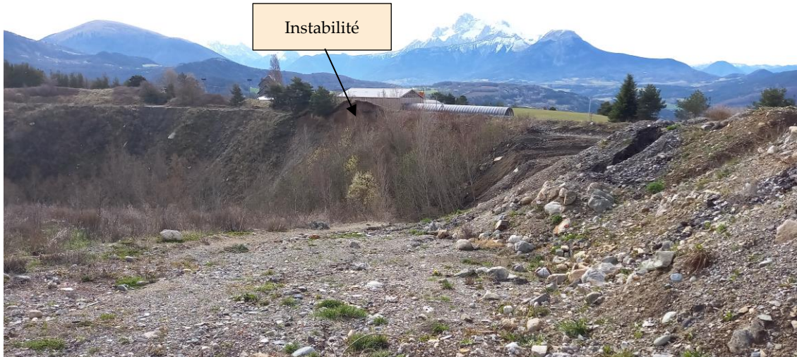
Photographie 32 : Instabilité des terrains périphériques, le long de la route RD 26
